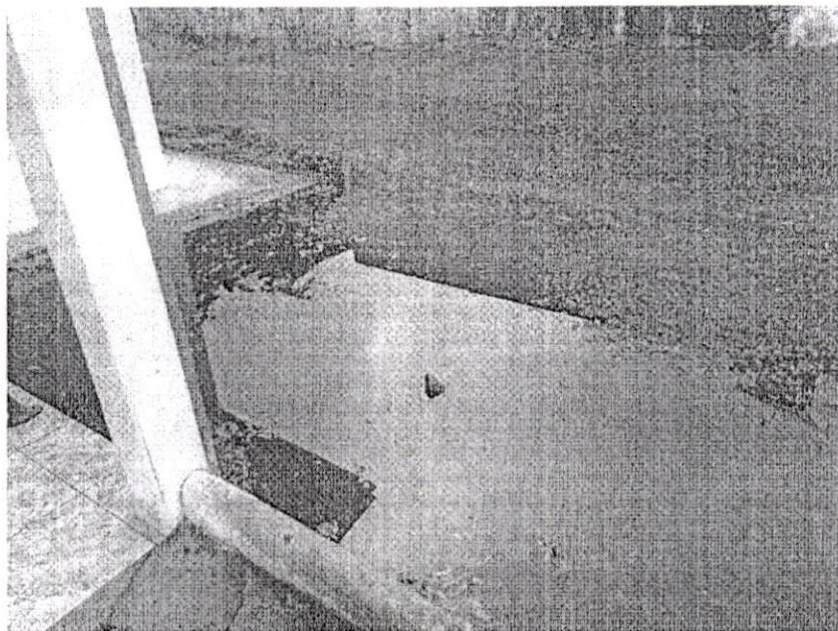
Foto 3 – Local do pátio com problema de drenagem.
