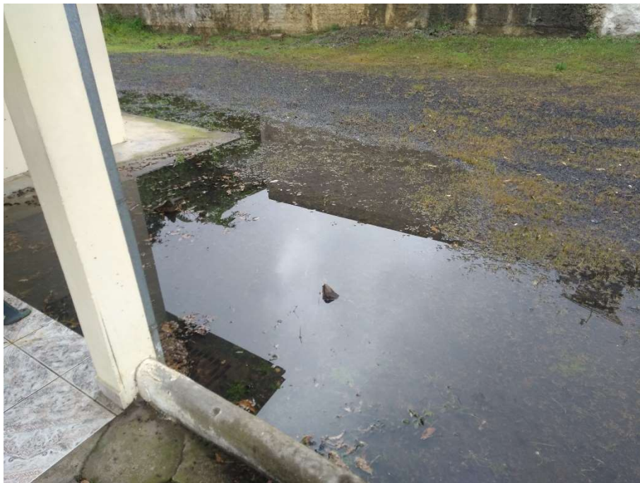
Foto 3 – Local do pátio com problema de drenagem.
